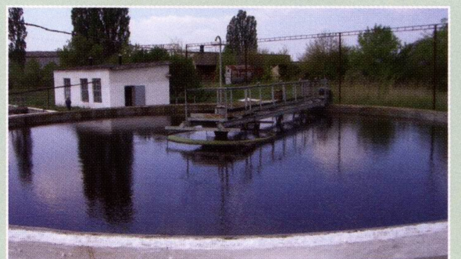
Водоочисні системи – первинні відстійники механічної очистки стічних вод
